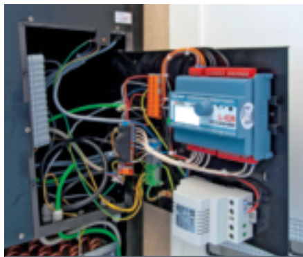
Die L-IOB I/O Controller stellen die Daten von den Trox-Schoolair Geräten bereit
