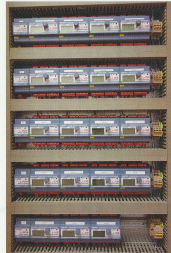
Unterverteiler mit L-IOB Modulen
